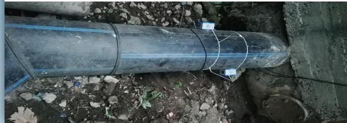
350mm, OHT Inlet HDPE Pipe
